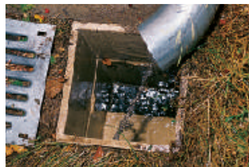
Zulauf in Rigole
