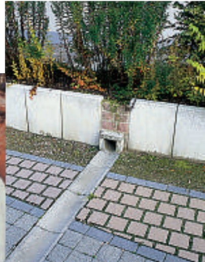
Überlauf Regenwasserspeicher in Mulde
